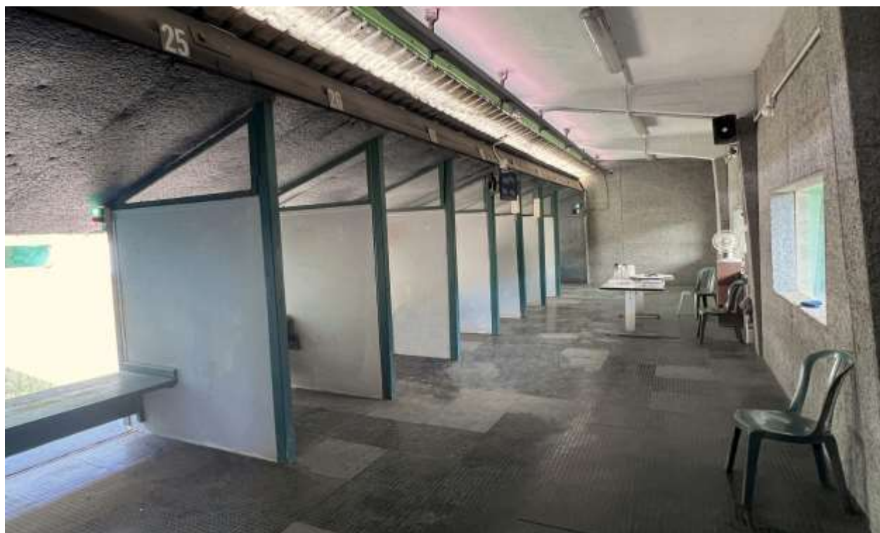
L’interno di un settore di tiro. si notano i setti separatori in acciaio balistico. Pareti e pavimenti sono rivestiti di materiali fonoassorbenti e anti rimbalzo.
